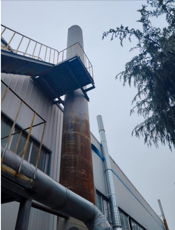
排气筒 P1+排气筒 P2
